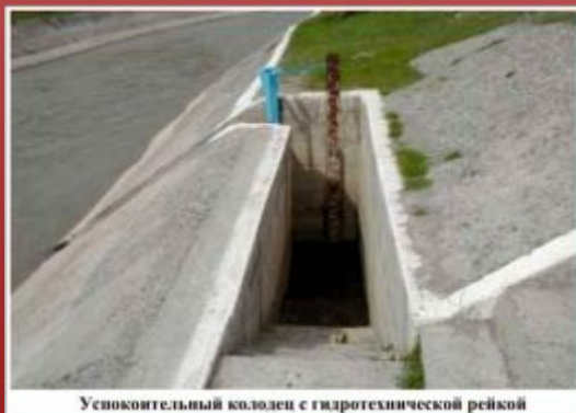
Успокоительный колодец с гидротехнической рейкой
